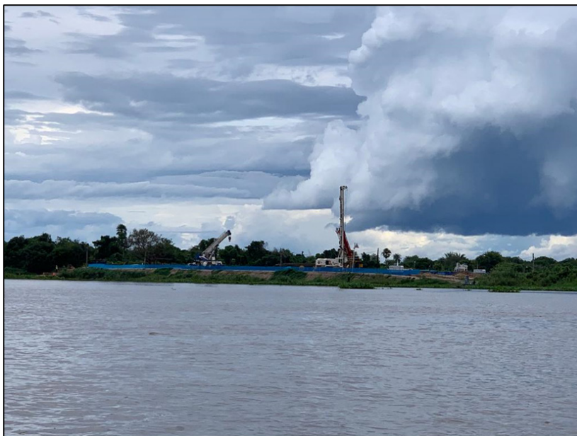
Figura 4. Obras del Puente Binacional del lado brasilero. Fuente: archivo personal del autor.
