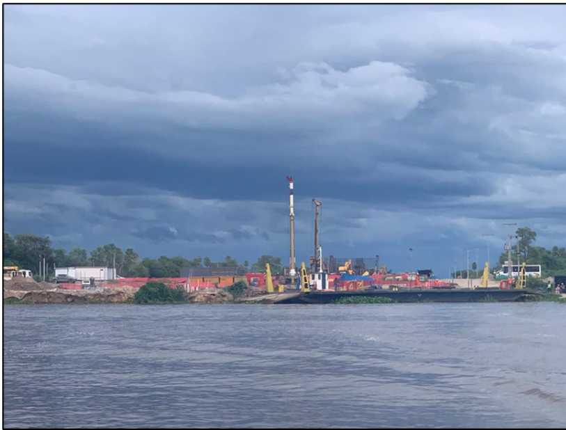
Figura 3. Obras en el Puente Binacional del lado paraguayo. Fuente: archivo personal del autor.
